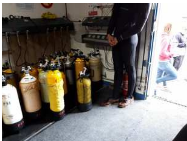
Fig 1. Zone de gonflage située dans le passage de la clientèle
